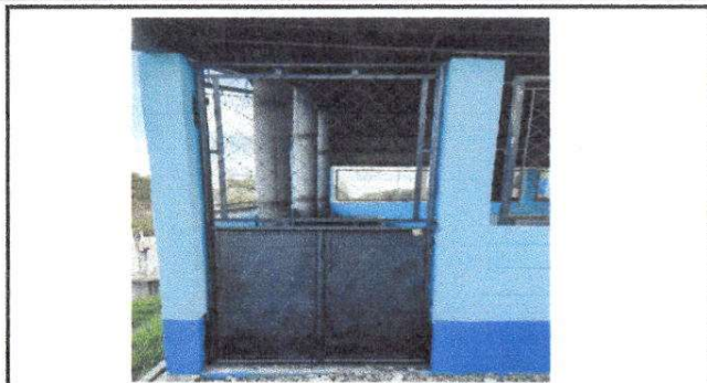
Foto 2: Mantenimiento de estructura: lijado y aplicación de pintura en puerta de metal del módulo 2 cocina
